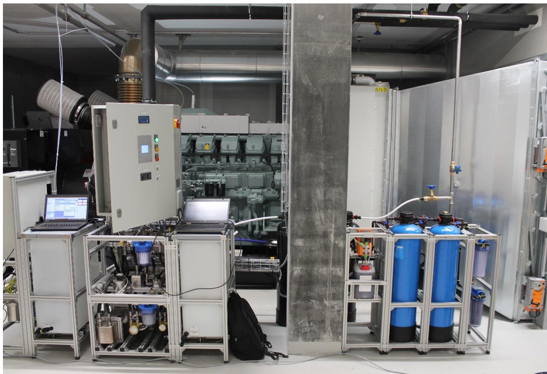
Notstromaggregat NEA · 2 x Mitsubishi S12R-PTA · 1190 kW NTS colobern · Bern · Schweiz
