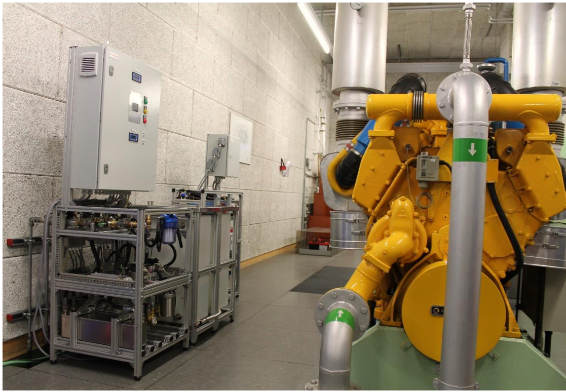
Notstromaggregat · Detroit Diesel 9163-7306 (2-Takter) · 828 kWel Telekommunikationsunternehmen · Zürich · Schweiz
