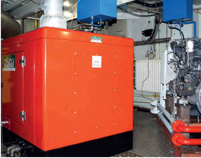
Mit den neuen Generatoren erfüllt die Stromerzeugung die Abgasnorm ZKR II
